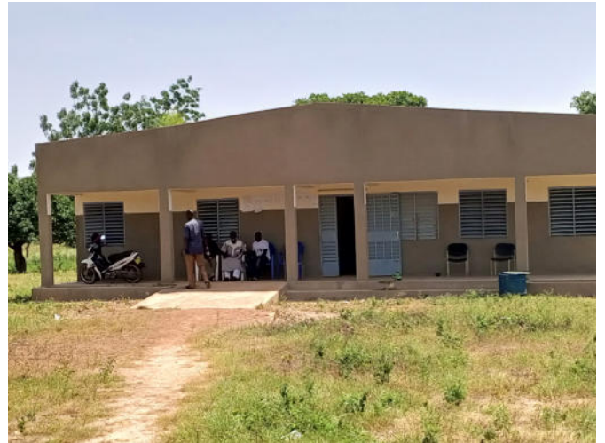
Dies ist das Administrationsgebäude der weiterführenden Schule, dessen Dach mit Solarpaneele zur Stromversorgung ausgestattet wurde.
