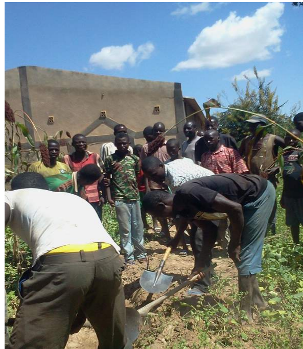
Die Stromleitungen werden im Boden händisch gegraben und von den Dorfbewohnern selber verlegt (Foto).
